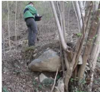
Foto 6: accumulo di frana appoggiato agli alberi lungo il pendio a monte della strada - settore terminale lotto.
