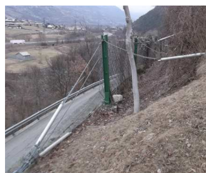
Foto 7 la barriera paramassi che difende la strada dell' envers interessata dal crollo di piccoli blocchi.
