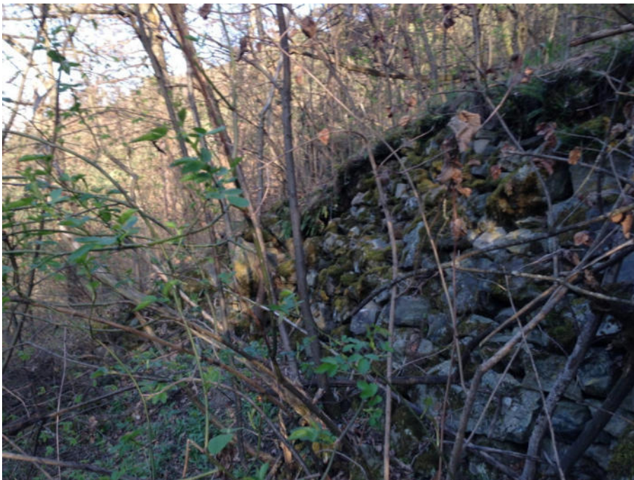
Foto 26: Terrazzamento agricolo ammalorato costituente la situazione di dissesto N.
