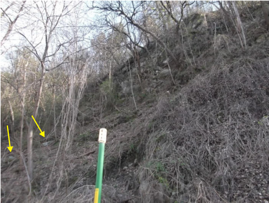
Foto 2: Particolare della situazione di dissesto A, con evidenziati alcuni blocchi di crollo recenti.
