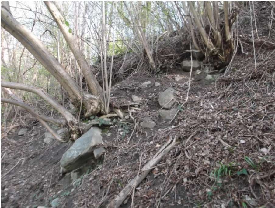
Foto 18: Particolare di alcuni blocchi semi immersi nel deposito di geni mista resi instabili dallo scivolamento delle coltri.
