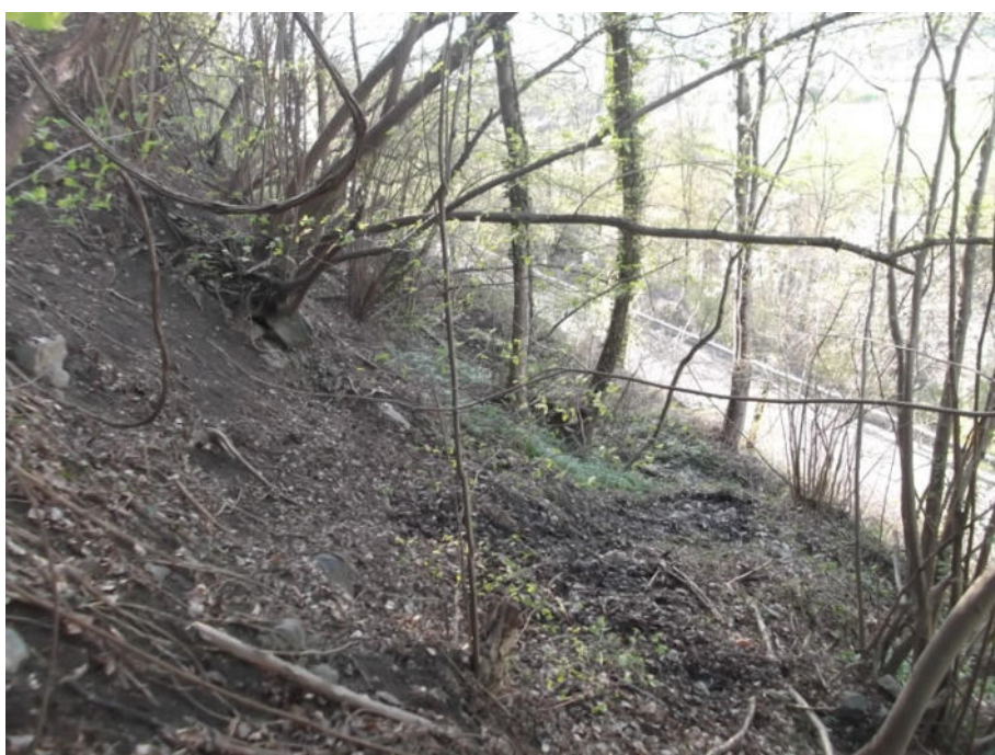
Foto 17: Terreni imbibiti al piede del pendio poco a W della vasca che rappresentano la situazione di dissesto G, situazione di dissesto diffusa con scivolamento delle coltri.
