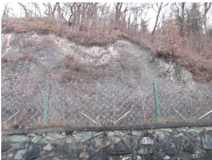
Foto 31: tratto di scarpata ricoperto da rete a doppia torsione bisognosa di manutenzione per la presenza di sacche di detrito.
