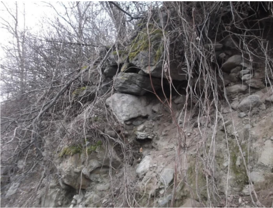
Foto 22: Situazione di dissesto L, scarpata direttamente a monte della barriera
