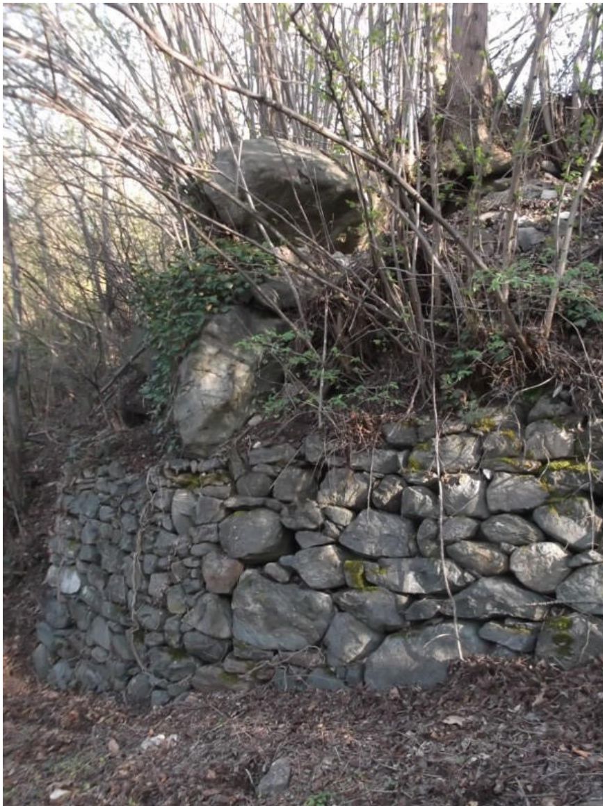
Foto 21: Terrazzamento agricolo ammalorato con blocco glaciale potenzialmente mobilizzabile (situazione I).
