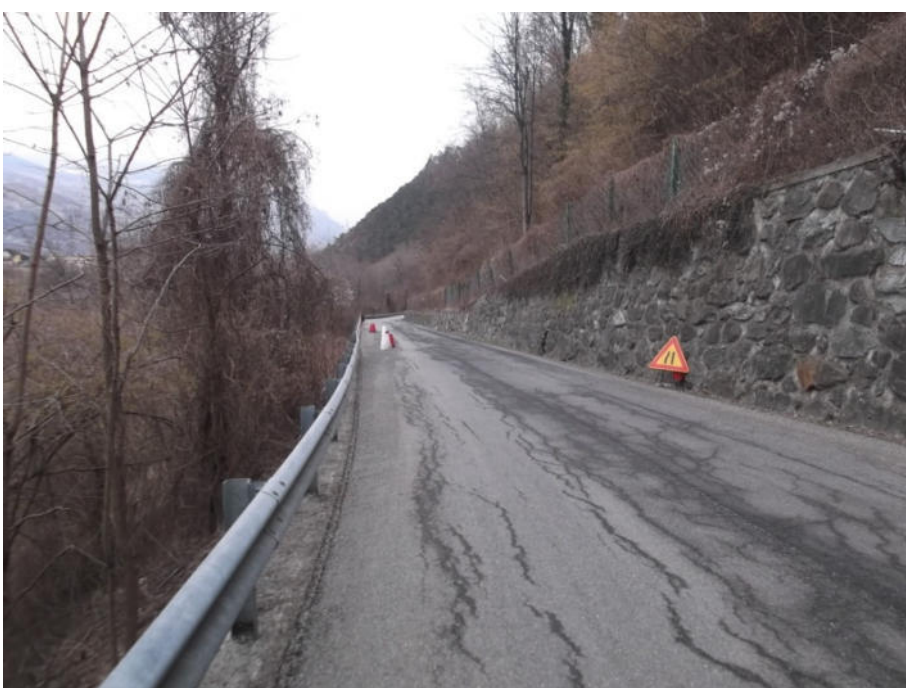
Foto 29: Vista del tratto mediano dell'area di studio nel 2018 con la strada ancora lesionata (attualmente sistemata) poco a E del tratto di pendio interessato dalle emergenze idriche della situazione G
