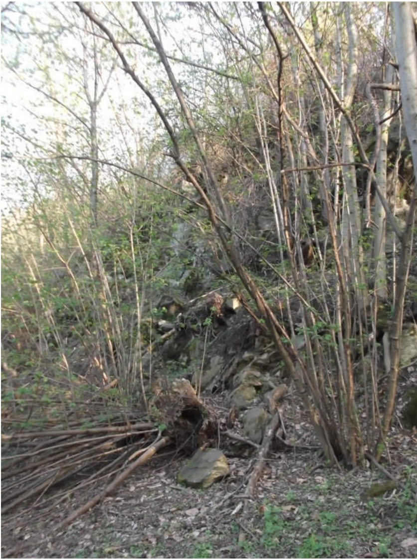
Foto 25: Particolare della scarpata rocciosa di quota 570m costituente la situazione di dissesto M, interessata da alcuni crolli recenti
